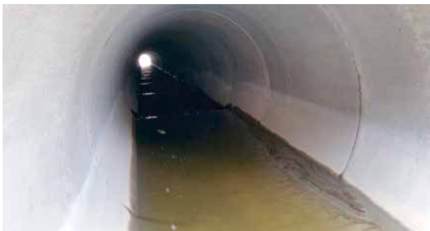
TERSKLER: I Flora ved riksvei 14 har det blitt gjennomført flomsikringstiltak med spesielle krav til tilrettelegging for fisken. I alt 15 betongrør ble utstyrt med spesialtilpassede terskler.
