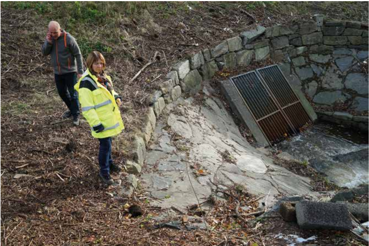
RISTER: Mye av utfordringene rundt rister, bekker og kulverter er uklare ansvarsforhold, mener er Monica Fredvik fagleder Avløp og Miljø i Kristiansand kommune. Her sammen med seksjonsleder i kommunen Torfinn Jore på befaring. Foto: Mona Sprenger
