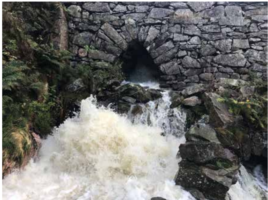
DAMMER: Kristiansand kommune er ansvarlig for mange gamle dammer som med mer ekstremvær har blitt en sikkerhetsutfordring. Foto: Kristiansand kommune
