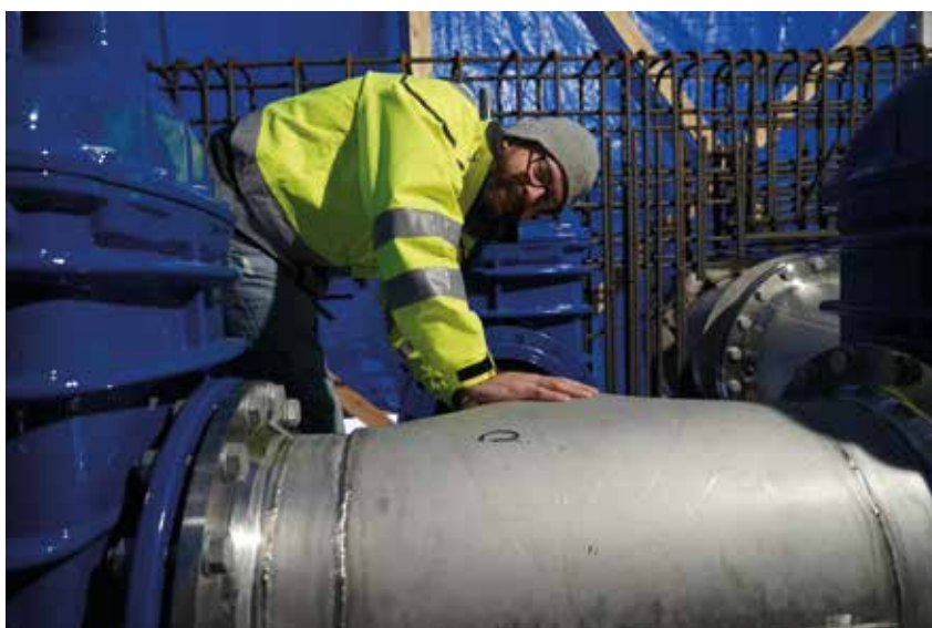
3D: Raymond Edvardsen, VA-ingeniør Norconsult har modellert vannkummen i 3D. – Ved å bruke 3D hadde vi veldig god kontroll på alle variablene. Vi kunne sende modellen fram og tilbake mellom de forskjellige fagdisiplinene, konstruksjon og VA, og ha full oversikt over endringer. Foto: Mona Sprenger
