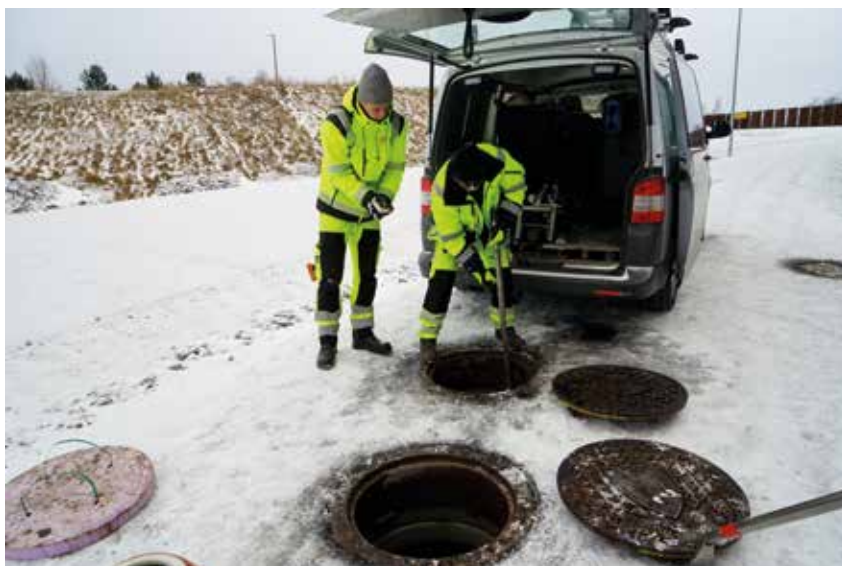
ENKELT: Nicolay Helgesen, trainee fra Norsk Vann og Svein-Ove Granerud fra driftsavdelingen i Ringsaker demonstrer at det slett ikke er vanskelig å stenge ventilene i den over fire meter dype kummen som er satt ned. Foto: Mona Sprenger
