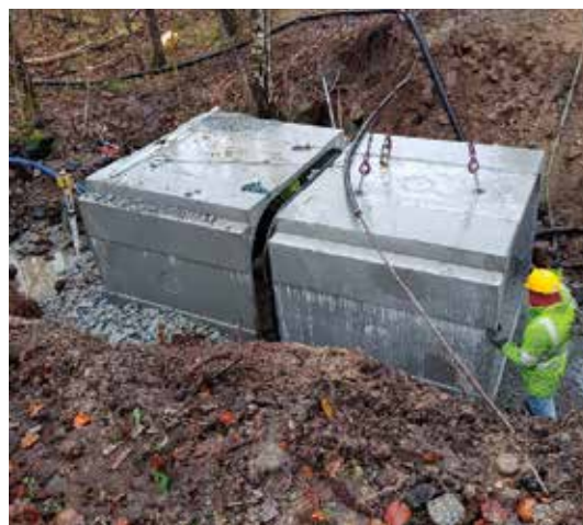
Box Culvert er to meter bred og halvannen meter høy. Foto: Inger Anita Merkesdal
