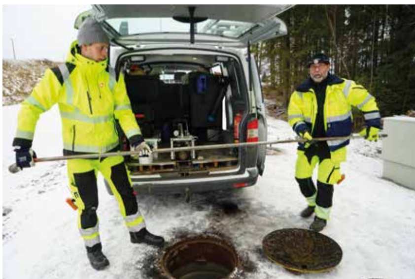
DYPE: Ventiler i kummer må stenges i forbindelse med vannlekkasjer og annet vedlikeholdsarbeid som må utføres. Det er derimot ikke risikofritt å gå ned i en dyp trykksatt kum. Foto: Mona Sprenger
