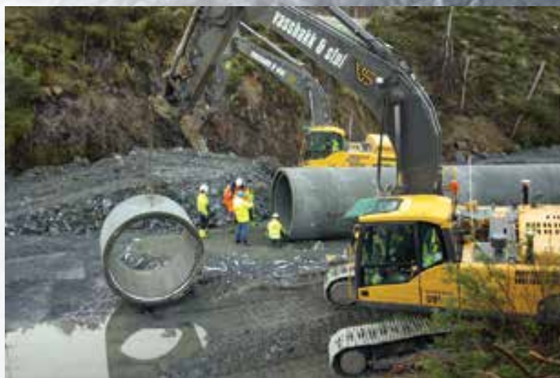
På få måneder har Vassbakk & Stol lagt ca. 270 meter med DN 2000, ca. 200 meter med DN 1400, samt en god del DN 800 og DN 600 betongrør.
