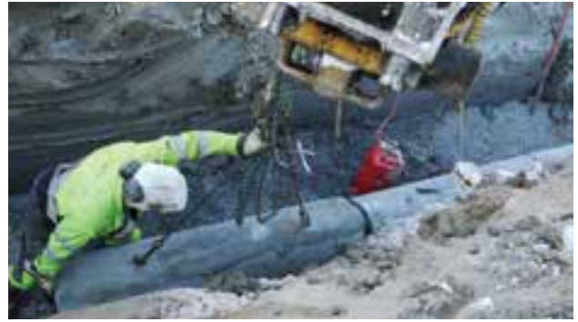
Egil Fredriksen fra Reinertsen AS monterer ytterligere en rørlengde på overvannsledningen. Grunnen i Trondheim består av leire, dette sees tydelig i grøftekanten her.
