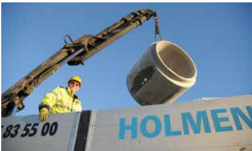
Holmen Betong AS har en betydelig betongleveranse til prosjektet i Lavangsdalen. Trond Stenseth er bedriftens sjåfør.
