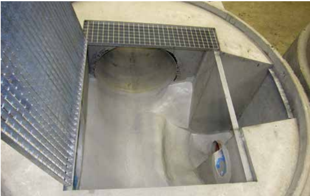
Spesialkummen fra BetoNor Vingrom har hengslet lokk, for å forebygge uhell. Hovedløpet har DN 800, og ledningene har stort fall, så overvannet vil få en veldig stor hastighet.
