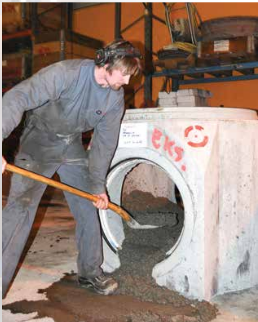
En egen spesialavdeling, med fire mann, spesialproduserer kummer kontinuerlig. Her er Kenneth Kvål i ferd med å støpe renne i en Basal Bunnseksjon type 2. Den har fleksible løp og skreddersys etter kundens ønsker.
