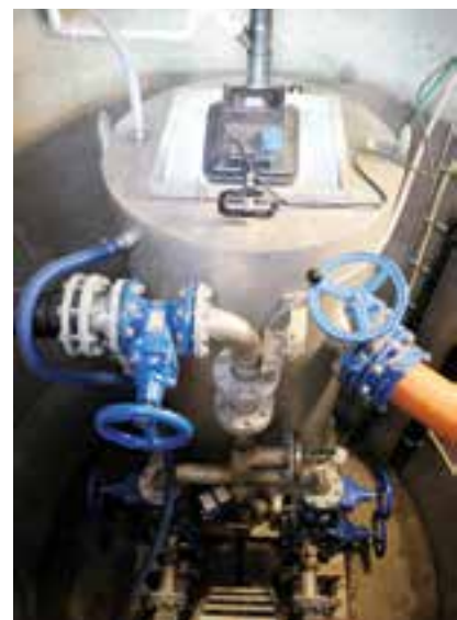
Sumpen og pumper er montert i en betongtank med åpninger for inspeksjon. Øverst på bildet sees taket i maskinrommet. Nederst er den øverste delen av tanken, med tilhørende utstyr, blant annet rør for lufting. På toppen av sumpen er også en lufttett luke med et pleksiglass i. Via glasset kan en se ned i sumpen.
