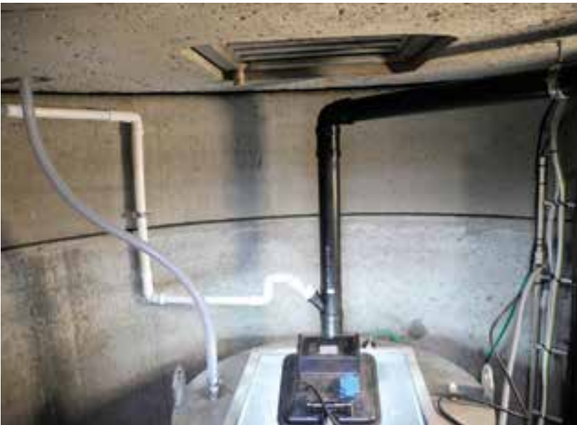
Magne Torgersen i Partner Vannrens AS i en av Basal pumpestasjonene firmaet hans har levert. Basal Pumpestasjon består av prefabrikkerte elementer, og er blant annet helt lufttett. Til høyre på bildet er røret som fører luft fra sumpen og ut over tak via et kullfilter.
