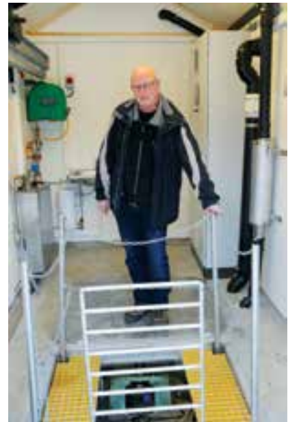
I maskinrommet av betong står sumpen og pumpene. På toppen av tanken gir en pleksiglassplate innsyn til sumpen.
