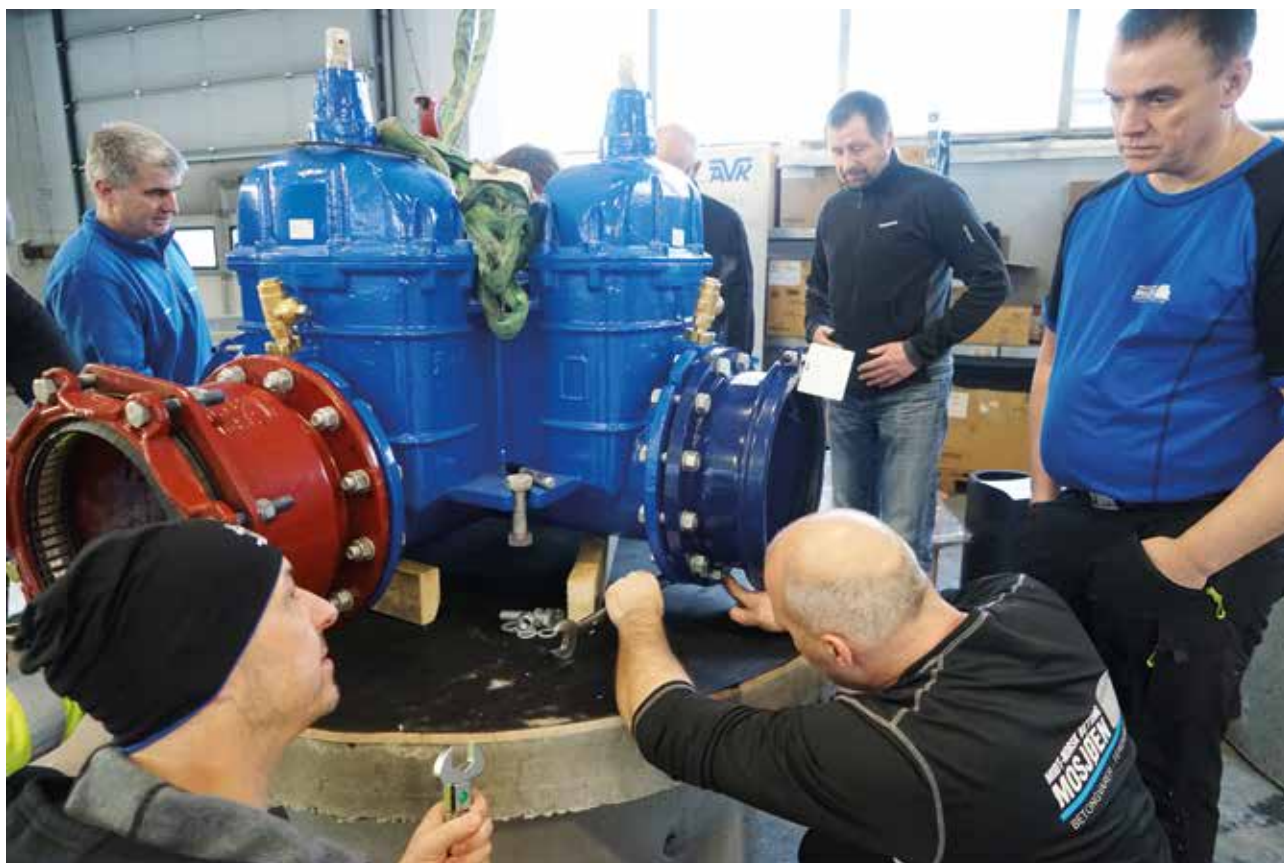
TRYGT: Vannkummene monteres innomhus i tørre og varme omgivelser. Foto: Mona Sprenger
