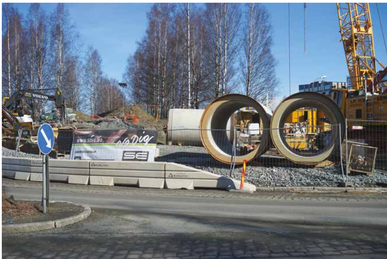
HASTER: Trondheim kommunen har valgt en VA-løsning som fungerer for alle forhold i området Sluppen, hvor det nå bygges nytt vegsystem. Foto: Mona Sprenger
