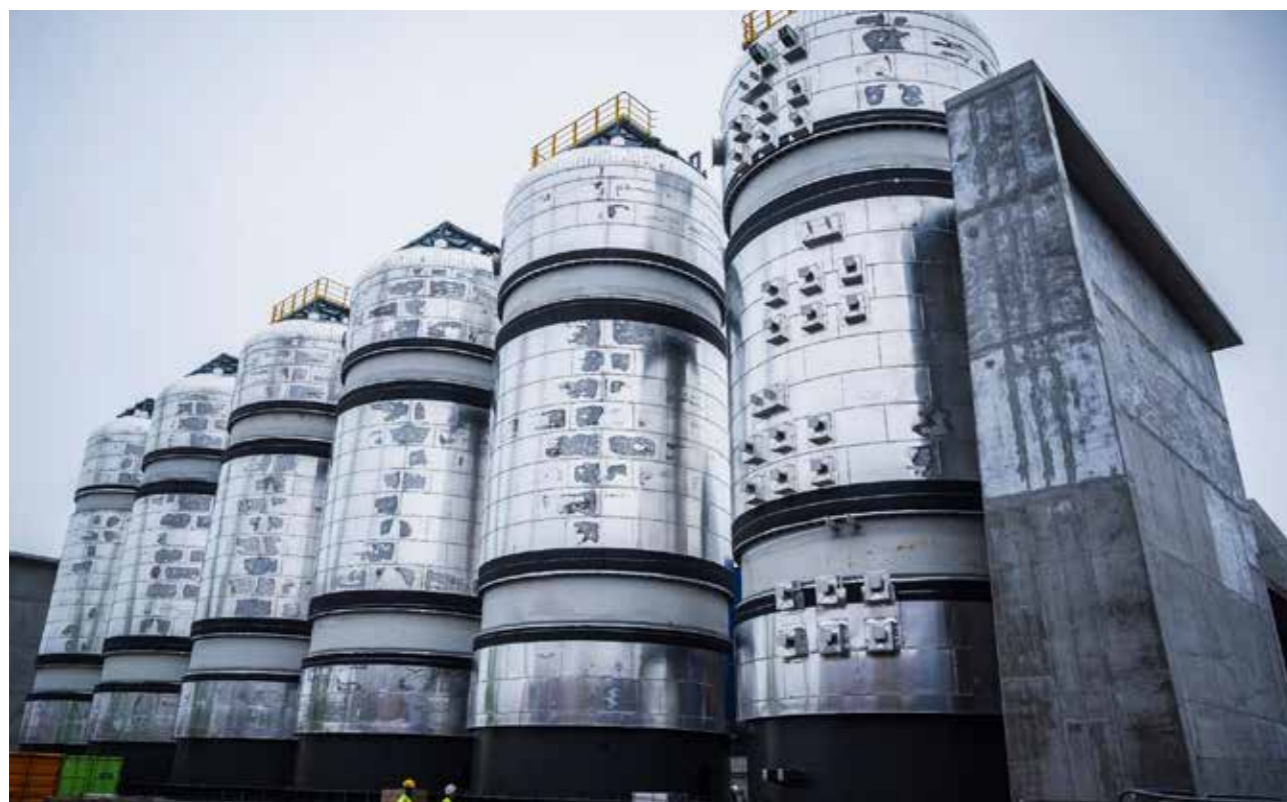
LAGERTANKER: Anlegget til Brevik CCS har enorme dimensjoner, og skal årlig kunne fange 400.000 tonn CO 2 . Lagertankene på bildet har kapasitet til å lagre 5000 tonn CO 2 , som siden skipes videre til Nordsjøen der gassen sendes i rør 11 mil fra land og til det endelige lageret som ligger 2600 meter under havbunnen.
