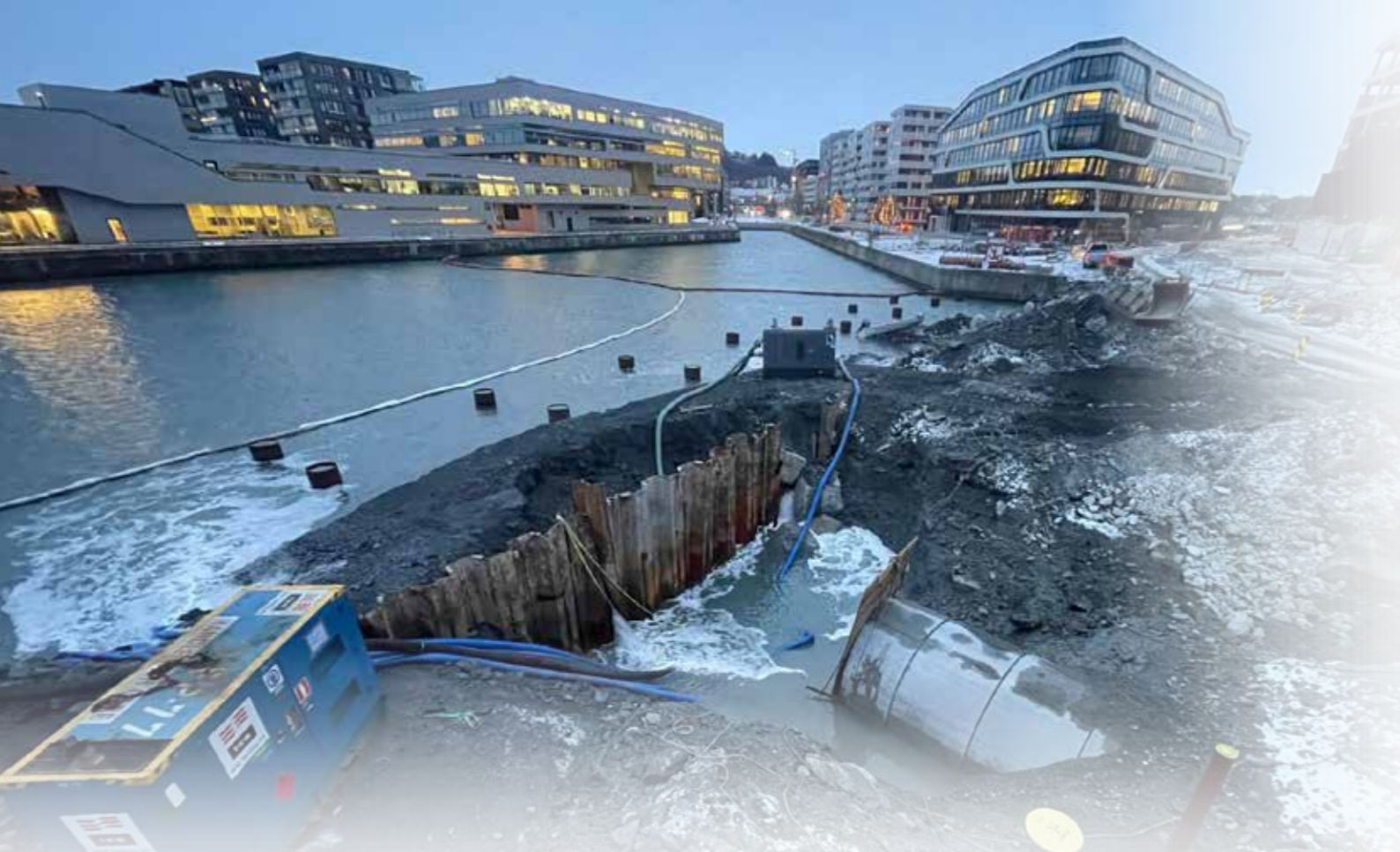
KOMPLISERT JOBB: I alt ble det lagt ut elleve meter med rør i sjøen. På bildet ser man koblingspunktet på land til høyre i bildet. For å få på plass det siste strekket ut i sjøen måtte man ha hjelp fra dykkere
