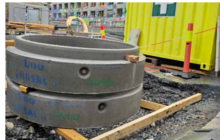
«VARIG» BETONGRING: Klar til å monteres og graves ned utenfor Møllergata 19 ved det nye regjeringskvartalet i Oslo.
