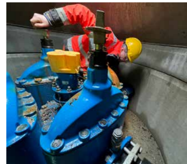
MANGE FEIL: Terje Reiersen, teknisk direktør i Basal AS, gjør en grundig kumsjekk under forhånsbefaringen i Stavanger. 29 kummer ble sjekket, og man fant feil i alle kummer.
