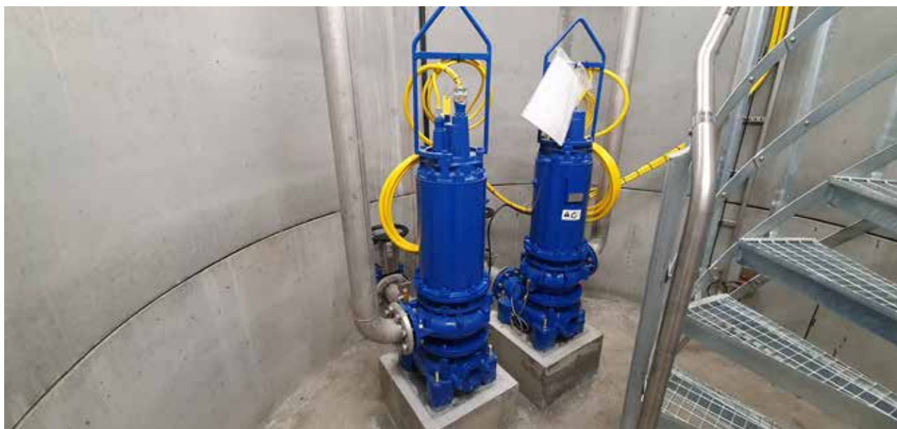
TØRT OG FINT: Pumpene står praktisk plassert og det er enkelt å arbeide rundt de. (Foto: Axflow)
