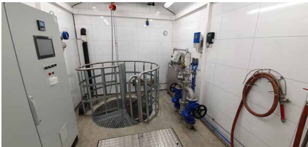
ENKEL TILGANG: Vindeltrappen gir enkel tilgang ned til et tørt og fint maskinrom.
