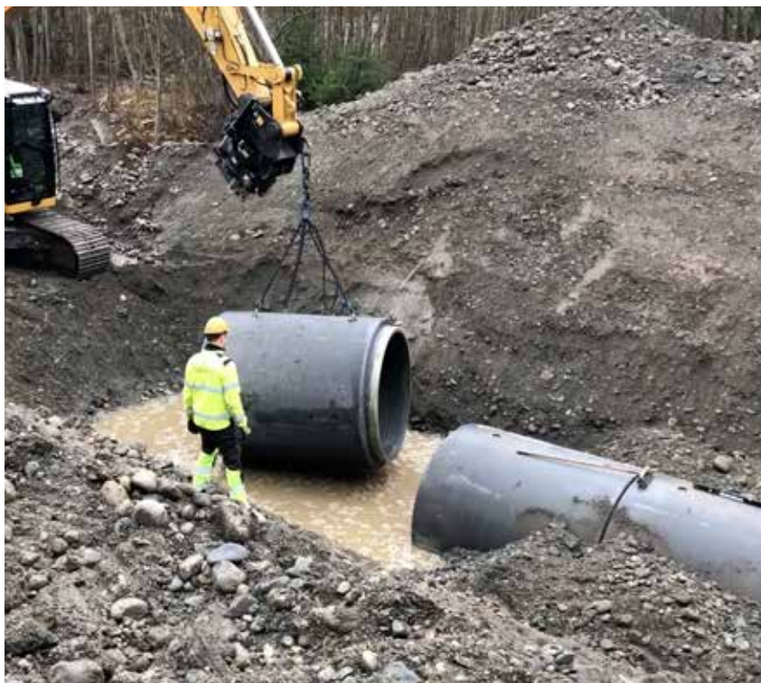
SAMARBEID: Kulverten ble prosjektert av NINA, bygget av 14 1600x2250 rør. Utførelsen sto SG Entreprenør AS for. (Foto: Odd Lykkja)
