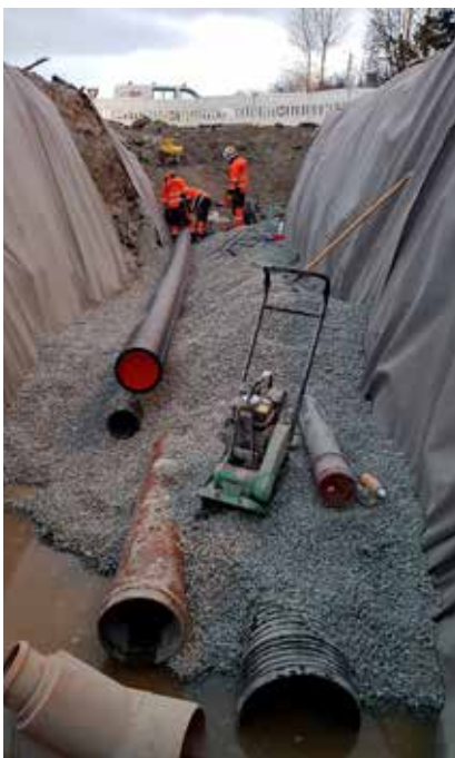
GRØFT: Le eller gråte? Ikke godt å si. Men det er i alle fall bortkastet pukk å pakke inn rør på denne måten. (Foto: Einar Sørensen Maskinentreprenør AS)
