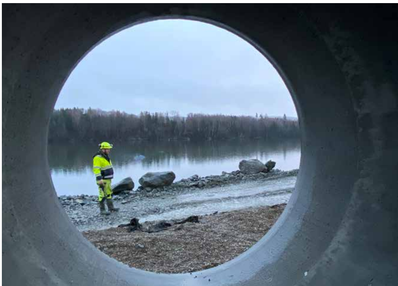
TETT PÅ ELVEN: Elven Vorma, som flytter vann fra Mjøsa til Glomma, går tett ved den nye jernbanen. (Foto: Jon Arild Holte, Loe Rørprodukter AS)
