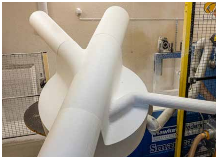
FERDIG: Ferdig frest forskaling til en spesialtilpasset renneløpskum med påmonterte rørgjennomføringer for å sikre gode hydrauliske forhold. Før kummen støpes monteres tilhørende pakninger avhengig av rørmateriale og dimensjon
